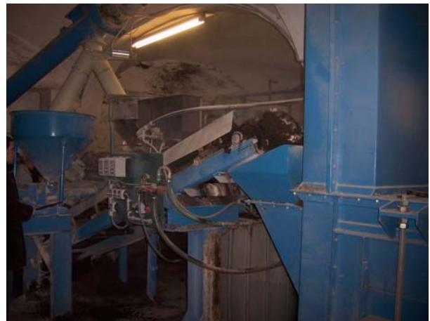
Mischanlage mit Dosierer
